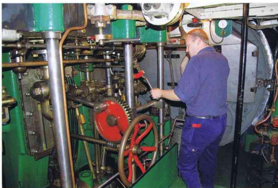
Maskinisten Mattias Bergsten vid manöverplatsen i Motala Express maskinrum den 1 juni 2007.
